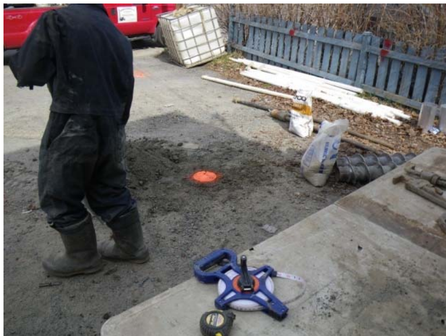
Photo 2 : Puits aménagé PO11-1
