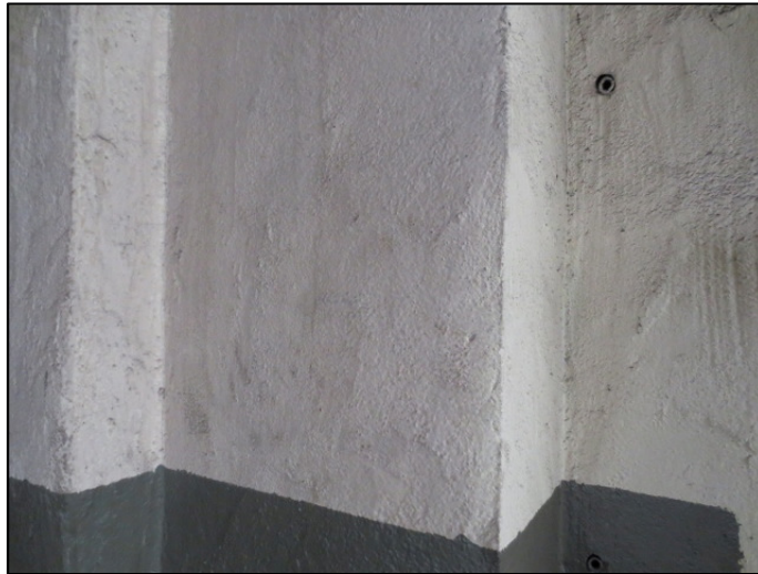
Photo 1 – Crépi cimentaire, contenant de l'amiante
