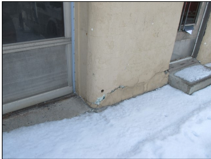
Photo 6 – Crépi cimentaire, contenant de l'amiante
