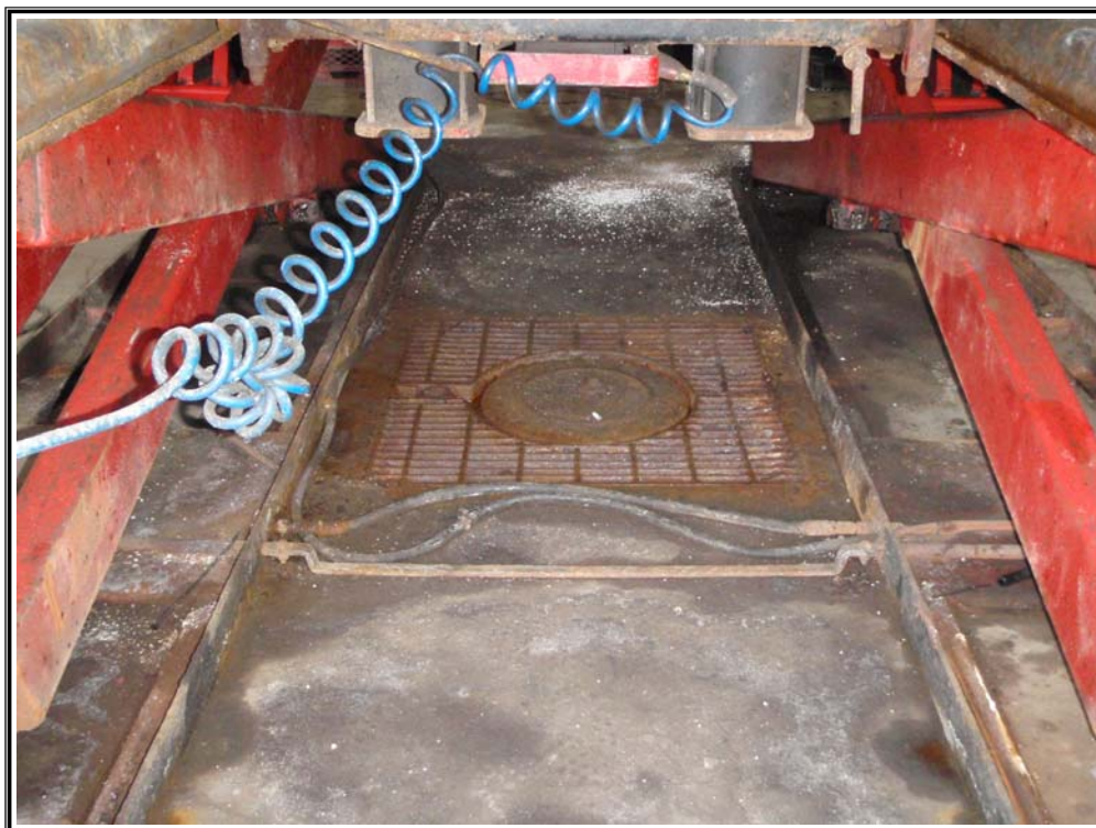
PHOTO 1 : Vérin hydraulique avec cylindre souterrain condamné.
