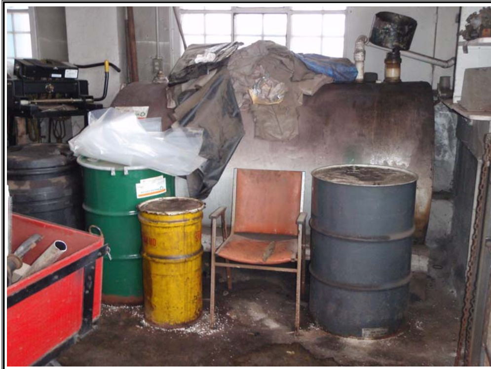
PHOTO 3 : Réservoir hors sol d'huiles usées (R-5).
