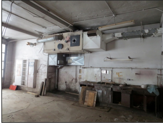
Photo 5 – Conduit de ventilation, non isolé
