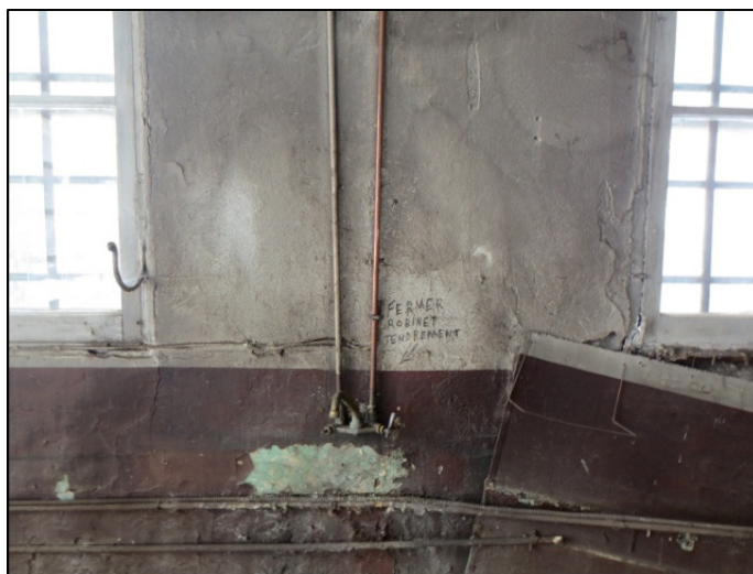
Photo 4 – Tuyauterie d'eau domestique, section rectiligne, non isolée
