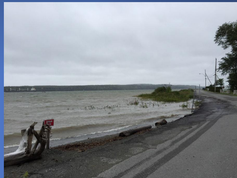
Dégradation de la route par les marées hautes
